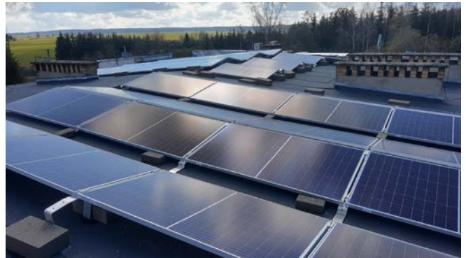
Elektrownia słoneczna na dachu Przedszkola
